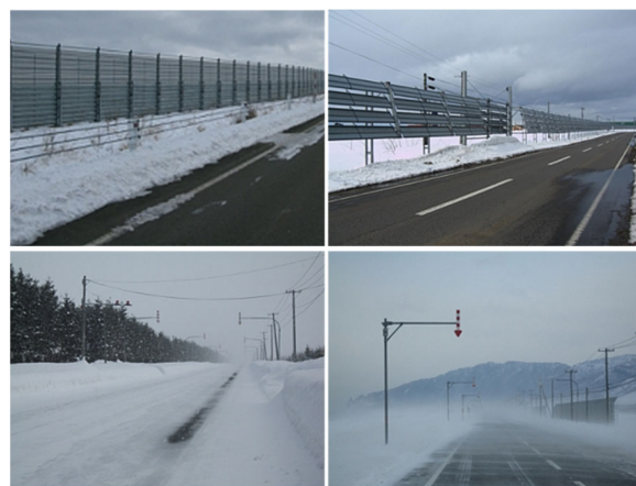
写真4 道路に設置された様々な吹雪対策施設 左上から順に吹き止め柵、吹き払い柵、道路防雪林、固定式視線誘導柱(視線誘導施設)。
