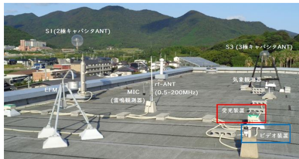
図4 屋上に設置した観測装置と受光装置
