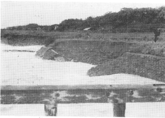
写真 1 大村市の北方を流れる郡川堤防破壊状況
