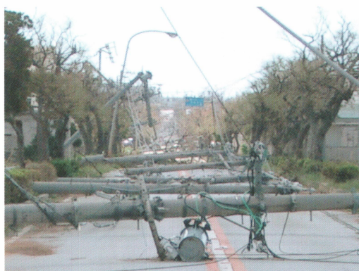
第5図 強風のため倒壊した電柱.
