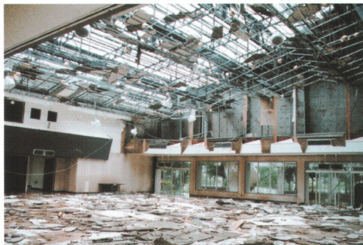
第4図 破壊された平良市中央公民館.
