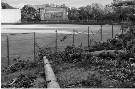
第2図 黄檗公園野球場の破損したフェンス (2009年8月5日18時57分 京都府宇治市五ヶ庄).
